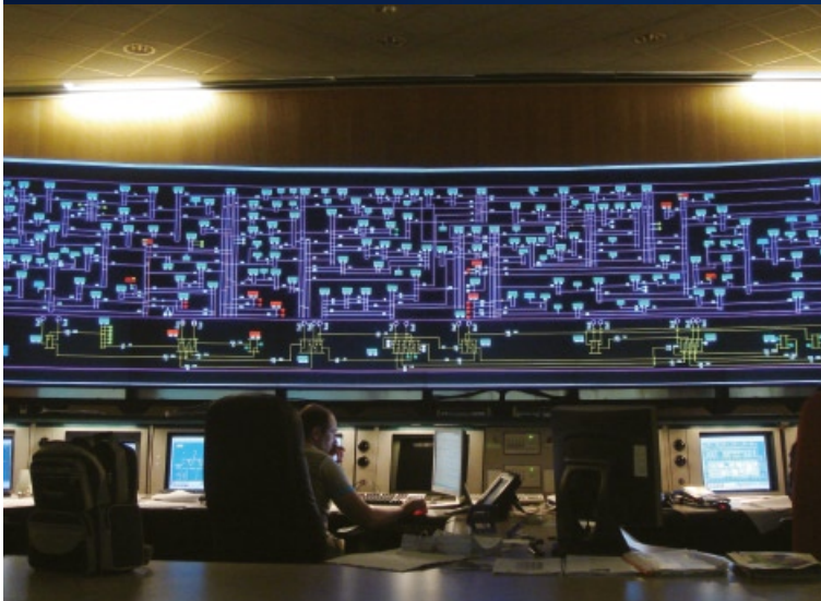
Kontrollraum eines Kraftwerks
